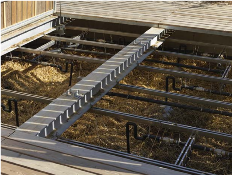
Plancher de la STEP ouvert
